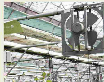
3겹 보온커튼과 환풍시설
